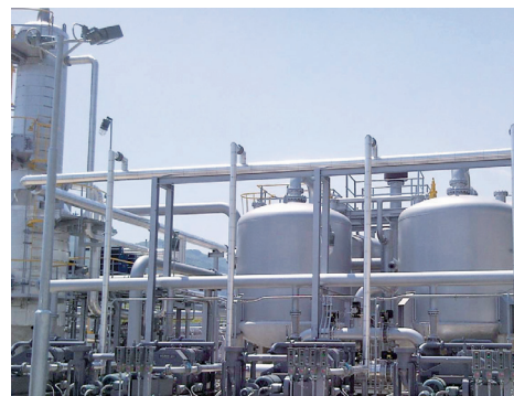
고효율 탈수-건조를 이용한 가축분뇨 고체연료화 시설
